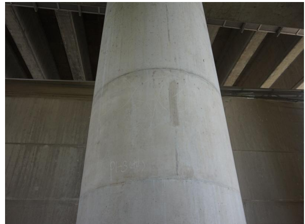
교각 망상균열 P1
