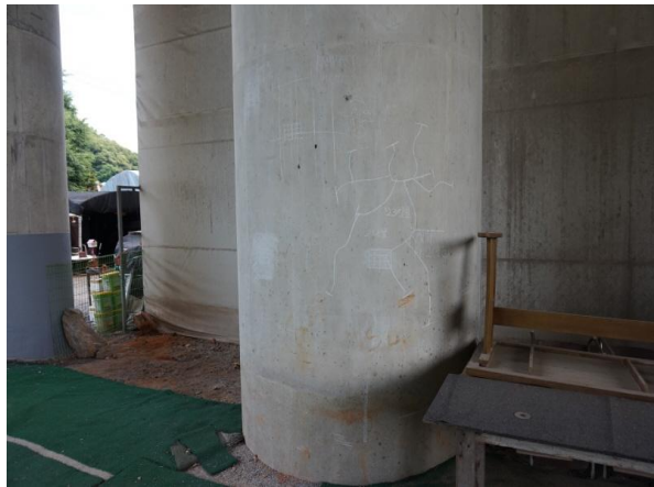
교각 망상균열 P1
